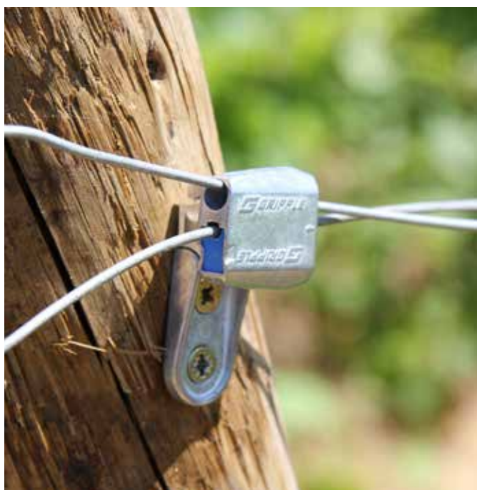
Kit VIT-S installato su palo in legno.
