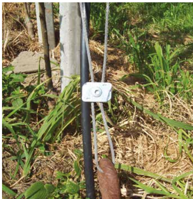
DPAK - Installato in un formato ad anello con strozzatura su un palo di cemento
