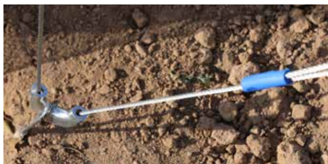
Sopra : Installazione fune sulla parte superiore del palo in legno Sotto : Accessorio anti scivolo e twister
